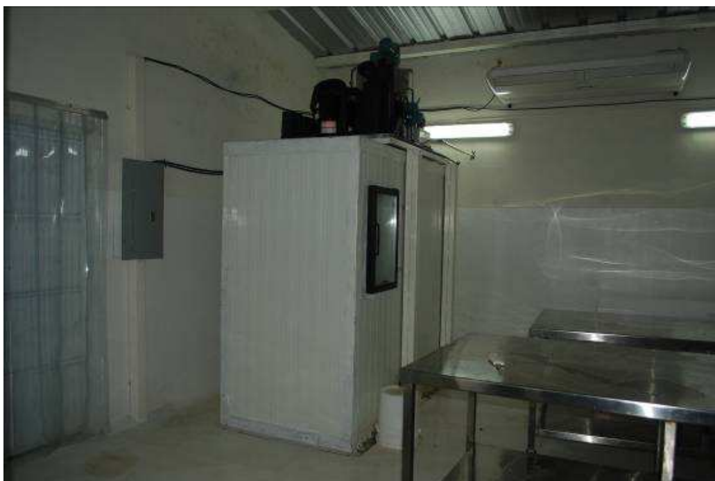
Foto 5: Interior de la planta de acopio y procesamiento Bocanalempa. Máquina de hielo.
